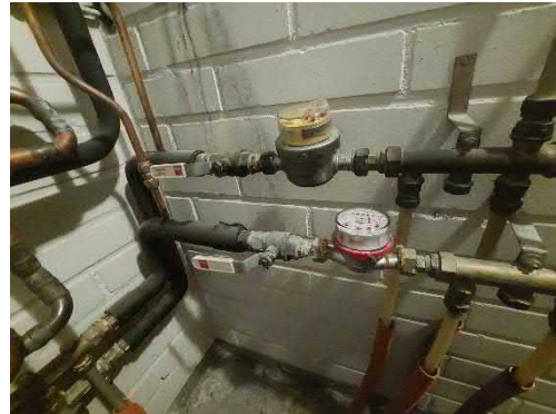
Alkuperäiset käyttöveden sulkuventtiilit.
