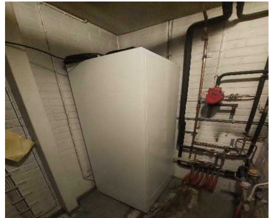
Tekniseen tilaan sijoitettu sähköinen lämpimän käyttöveden varaaja.
