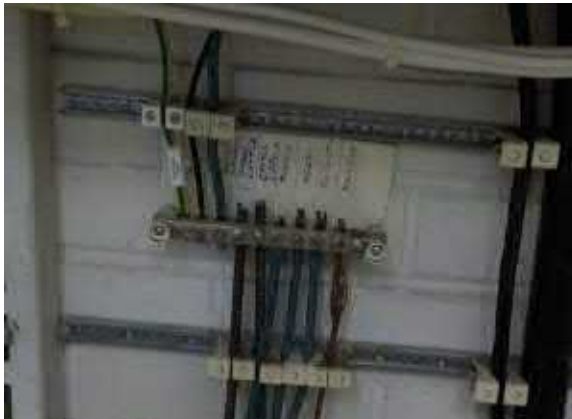
Maadoituskisko pääkeskuksen yhteydessä
