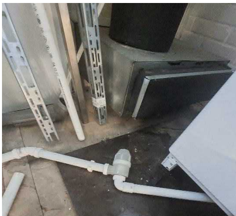
Väärin asennettu IV-koneen kondenssiviemäri.
