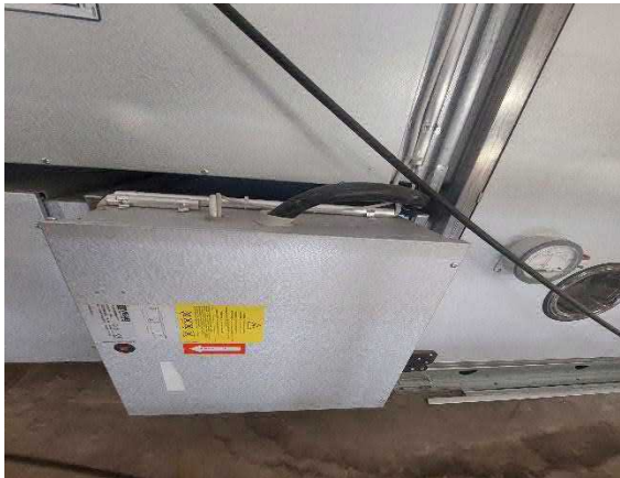
TK01 ilmanvaihtokoneen sähköinen lämmityspatteri.
