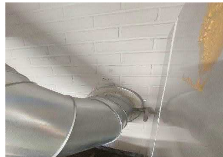
TK02-ilmastointikoneen poistoilmakanavan mekaaninen palopelti.
