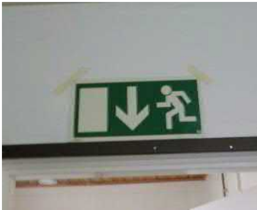
Jälkivalaiseva poistumistiekyltti oven yläpuolella
