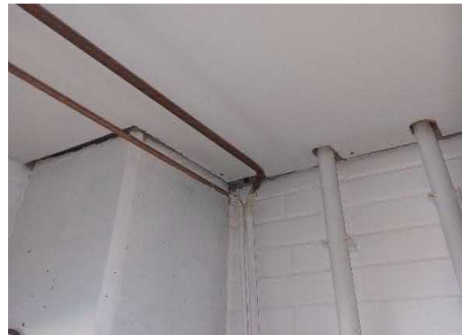
Osittain uusittuja ja osittain alkuperäisiä kuparisia käyttövesijohtoja.
