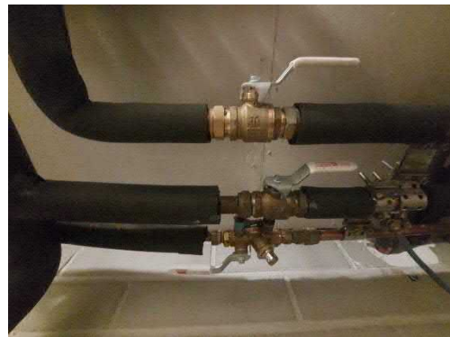
Uusitut käyttöveden sulku- ja linjasäätöventtiilit.
