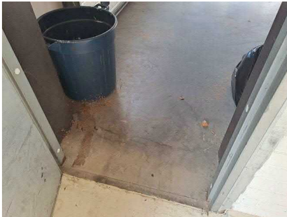
Yksittäisiä halkeamia laajennusosan alapohjarakenteessa
