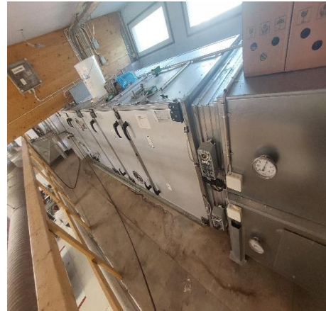
TK01 ilmanvaihtokoneen moottoritoimiset raitis- ja jäteilmapelit.
