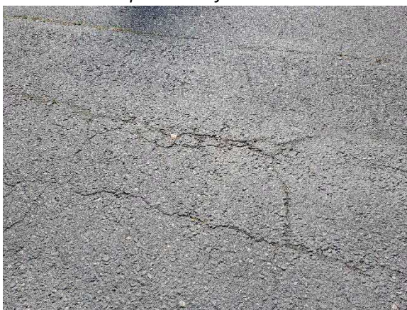
Asfalttipinnoissa tyypillistä halkeilua
