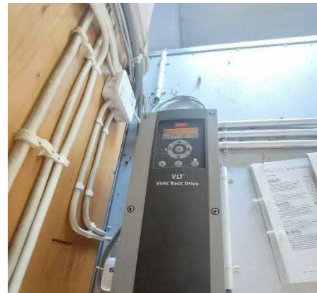
Ilmanvaihtokoneen puhaltimen taajuusmuuttaja.
