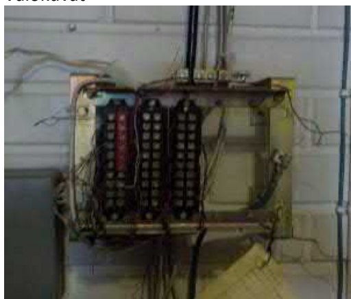
KytKentärimat teknisessä tilassa
