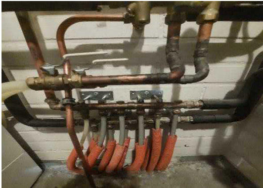
Kiinteistön sosiaalityöjen muoviset käyttövesisijohdot.
